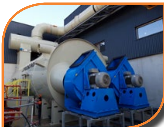
Traitement d'air par lavage
