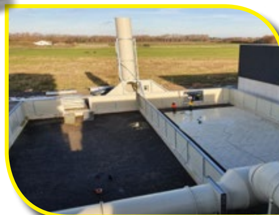
Traitement d'air par bio-filtration
