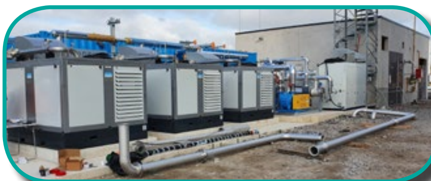
Module d'épuration du biogaz
